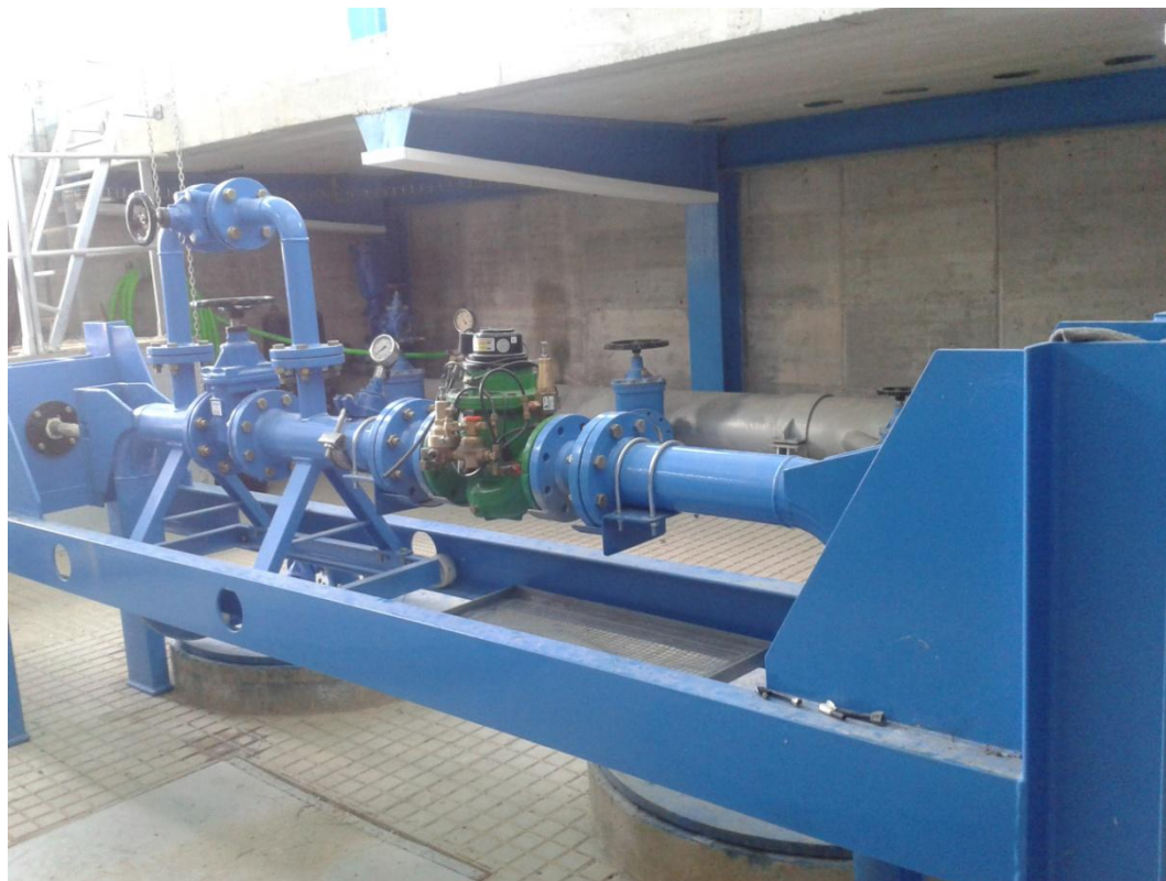
Imagen 3. Banco de Ensayos de AGUACANAL
